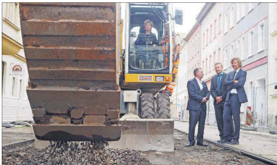
Ministerin für Infrastruktur und Landwirtschaft, Birgit Keller, vollzog gemeinsam mit (v.l.) OB Julian Vonarb, Geschäftsführer des ZVMW Gerd Hauschild und GVB-Geschäftsführer Thorsten Rühle den symbolischen ersten Baggeraushub. Lesen Sie untenstehend mehr dazu. Foto: Zölsmann
